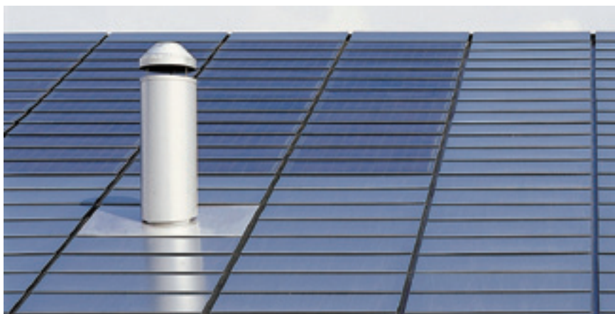
与屋面结合一体的太阳能光伏发电设施
