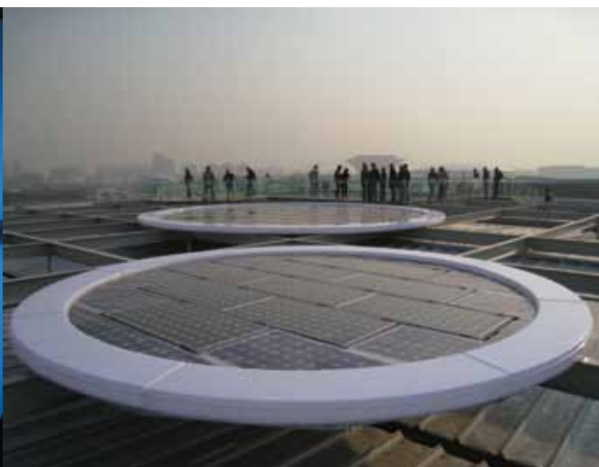
图15 太阳能光伏发电标示系统
