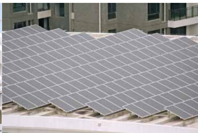
屋顶太阳能光伏板
