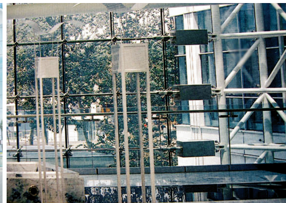
图95 防止地震时被拉断，钢索设置弹簧保险装置
