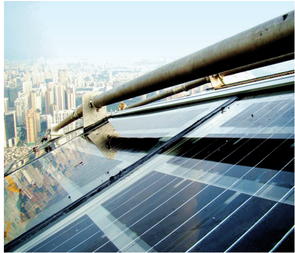
图49 顶部安装的合一式光伏组件
