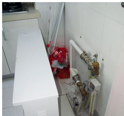
图15 水管入地处施工质量差（自摄）
