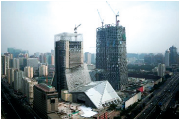
图10 建设中的电视文化中心：部分建成的空间框架后方可见巨型斜撑
