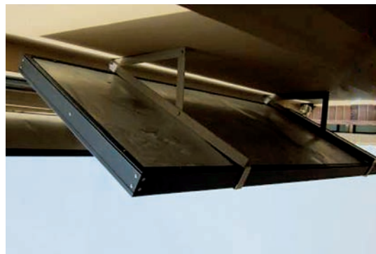
图16 集热器固定在外墙上
