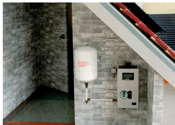
图27 水箱、控制器放置在屋面下面的閣楼里
